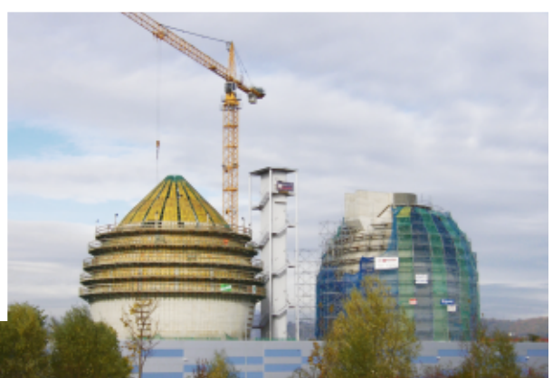
Kläranlage Kaditz, Dresden
