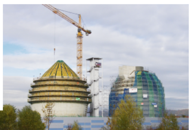
Kläranlage Kaditz, Dresden
